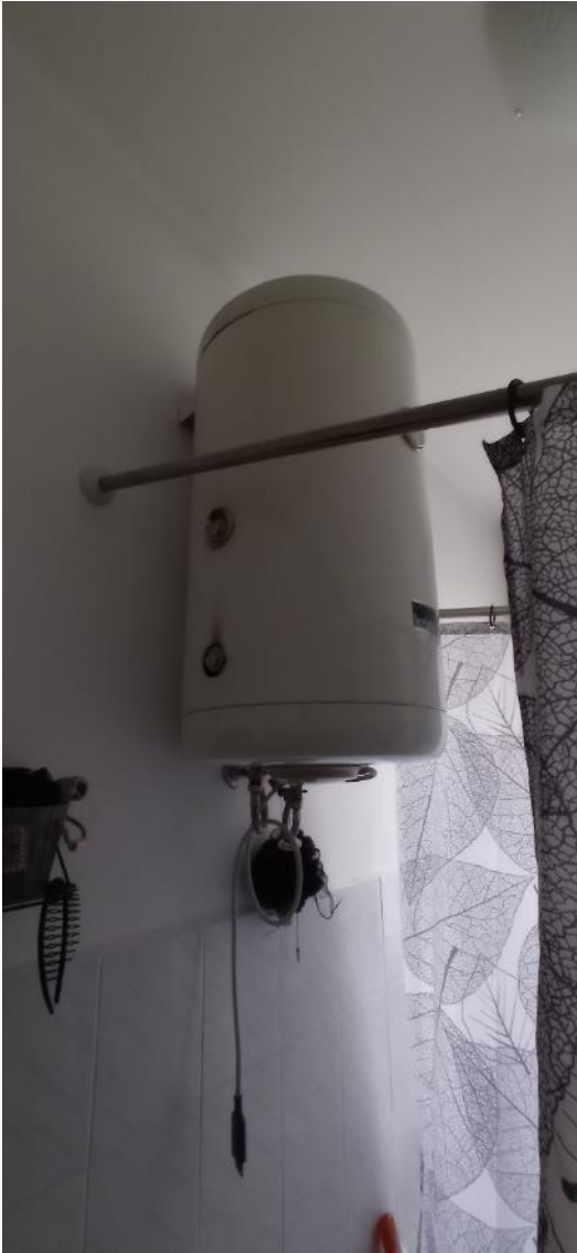
20. Bollitore acqua calda sanitaria
