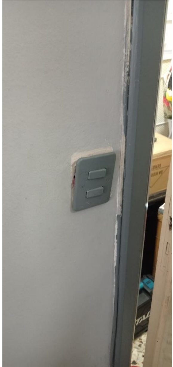
28. Dettaglio impianto elettrico
