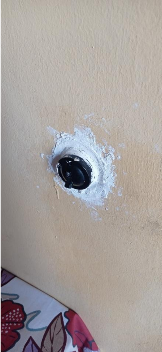
27. Dettaglio impianto elettrico
