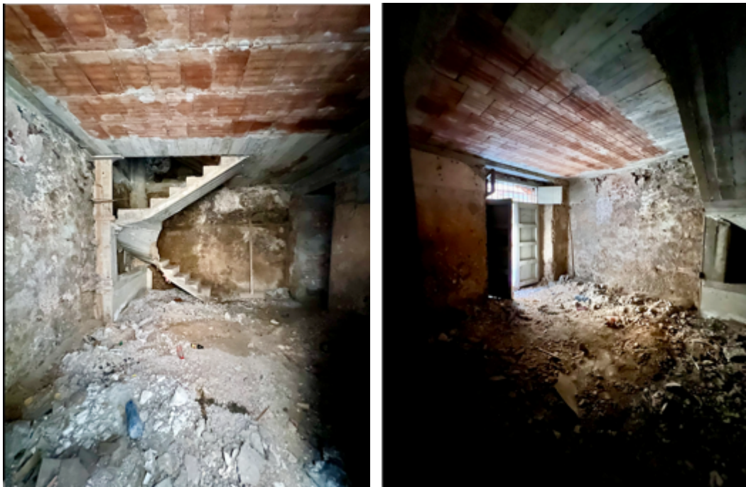
Figura 10 Immobile fg 74 part 426 sub 2 _ Interno
