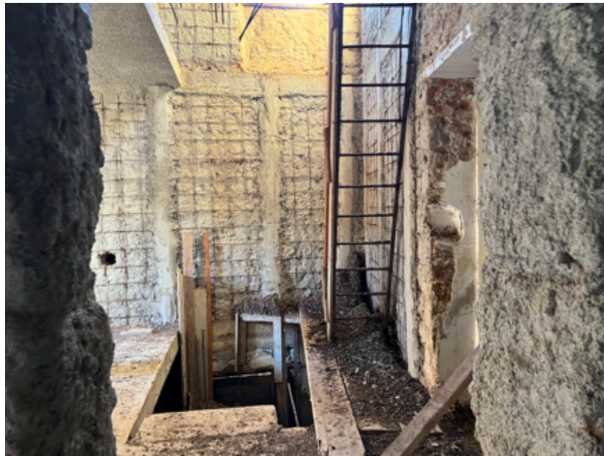
Figura 17 Sub 3 piano secondo _ Scala in ferro per accedere al sottotetto
