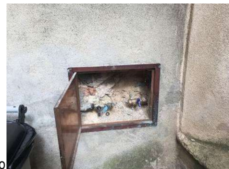
Vano contatore acquedotto
