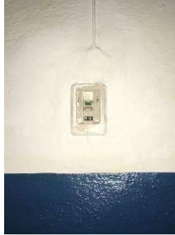
Interruttore magnetotermico di comando boiler bagno piano terra
