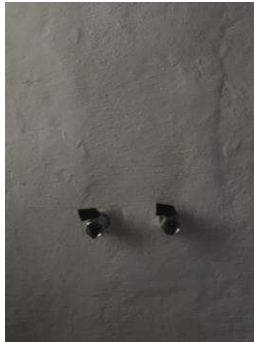
Attacchi Boiler bagno piano terra
