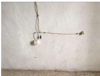
Impianto elettrico camera da letto
