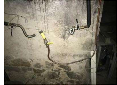
Attacchi caldaia nei locali seminterrati
