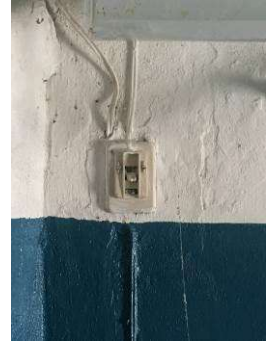
Interruttore magnetotermico di comando boiler bagno piano primo
