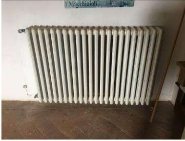
Radiatore locale piano terra
