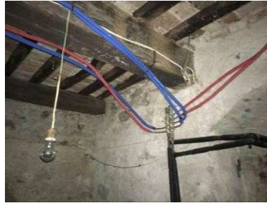
Tubazioni riscaldamento nei locali seminterrati
