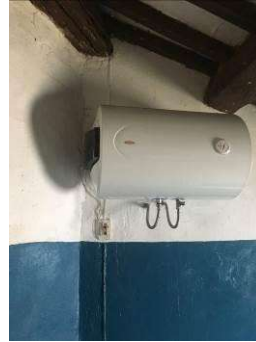
Boiler bagno piano primo
