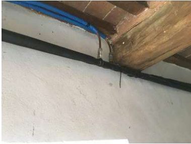
Tubazioni riscaldamento nei locali seminterrati
