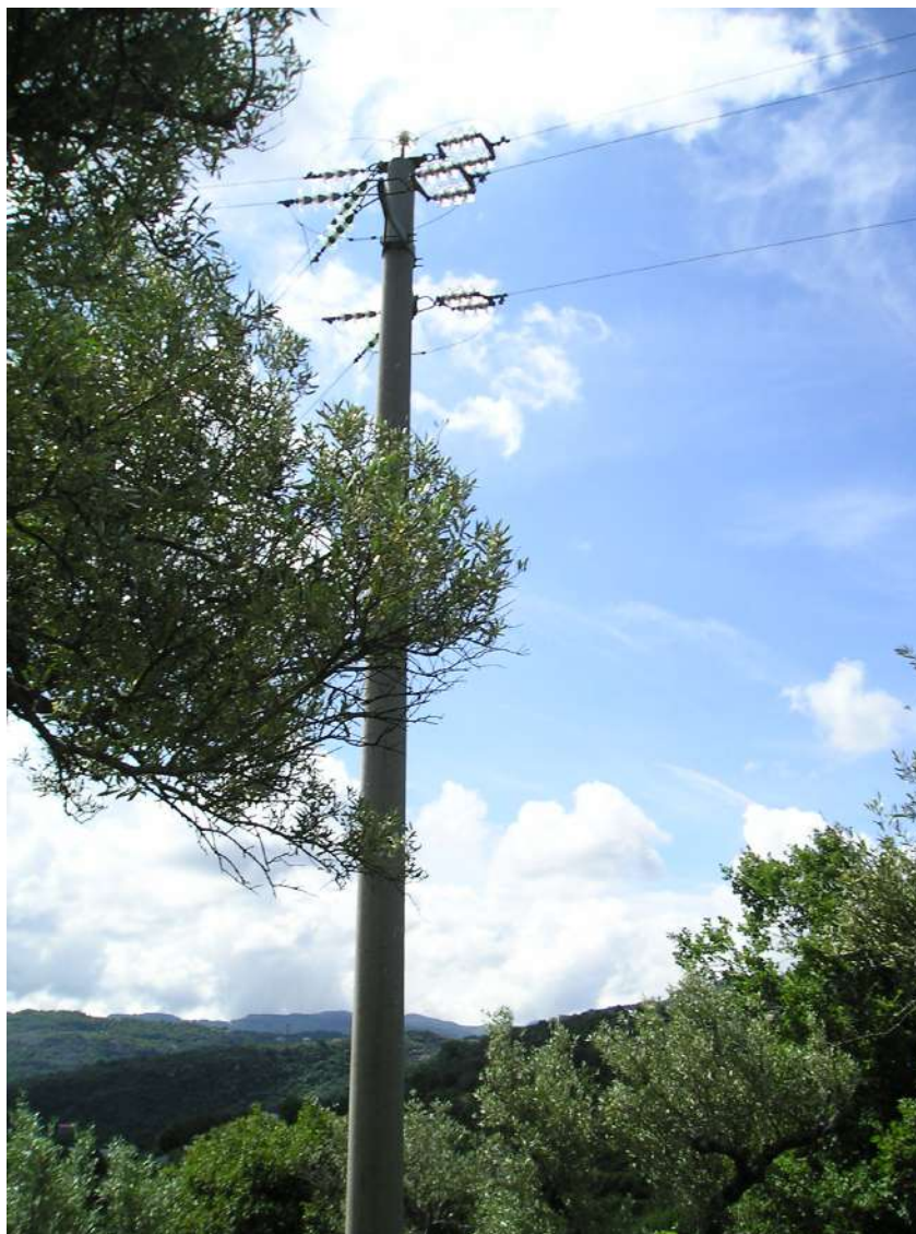
Foto n. 41: Immobile 3 – particolare elettrodotto
