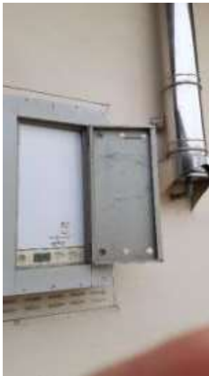
Foto 13: Caldaia murale esterna
