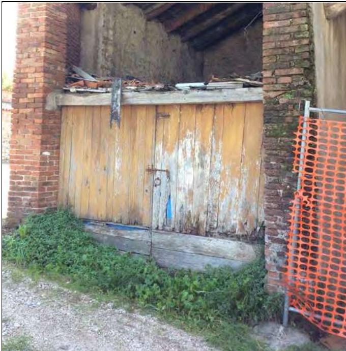
Foto 13: PT Esterno (impossibile accedere in quanto pericolante)
