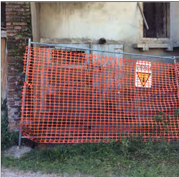
Foto 15: PT Esterno (impossibile accedere in quanto pericolante)
