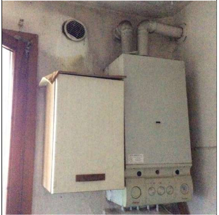
Foto 6: PT Caldaia posta all'interno della cucina
