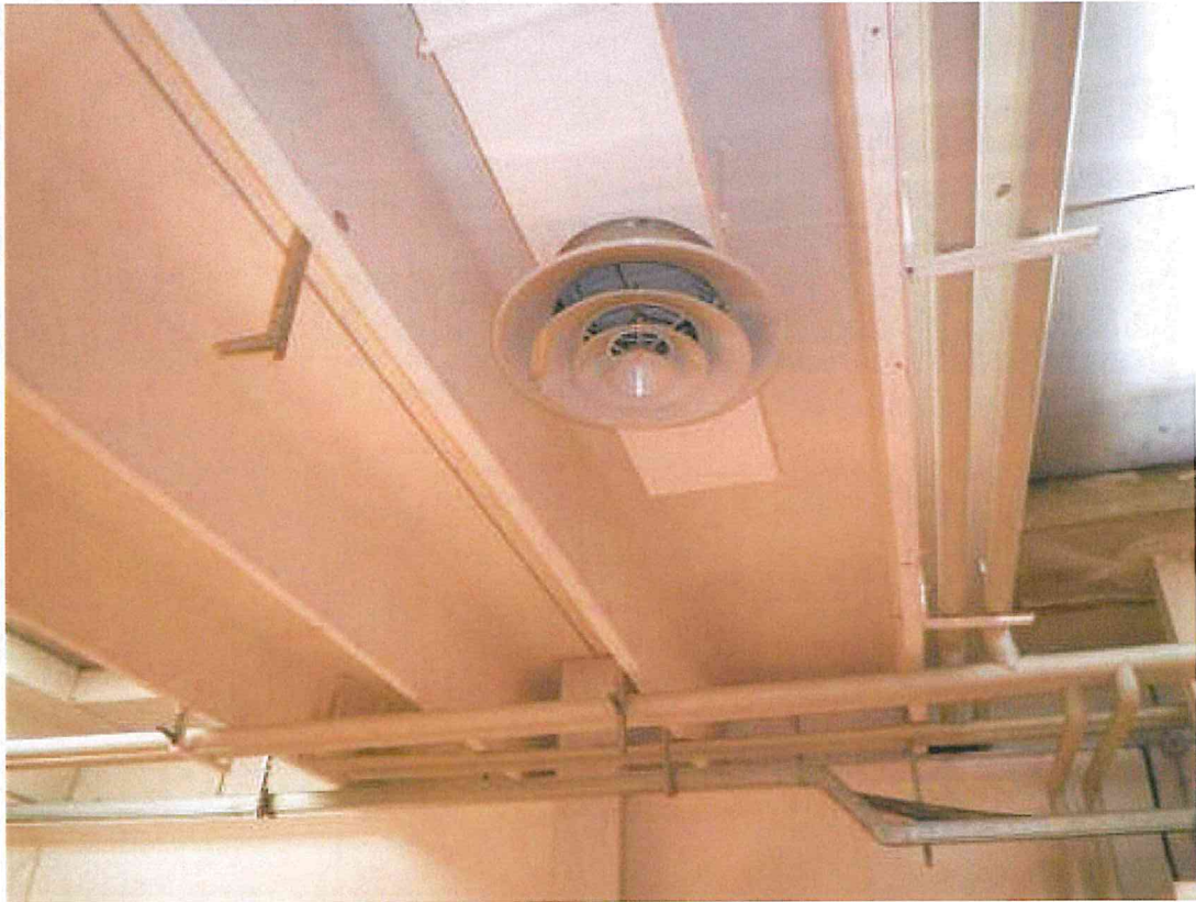
Foto 05 – Gli impianti esistenti
