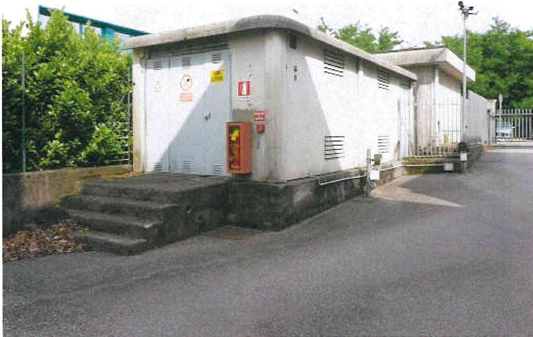
Foto 17 – La cabina elettrica
