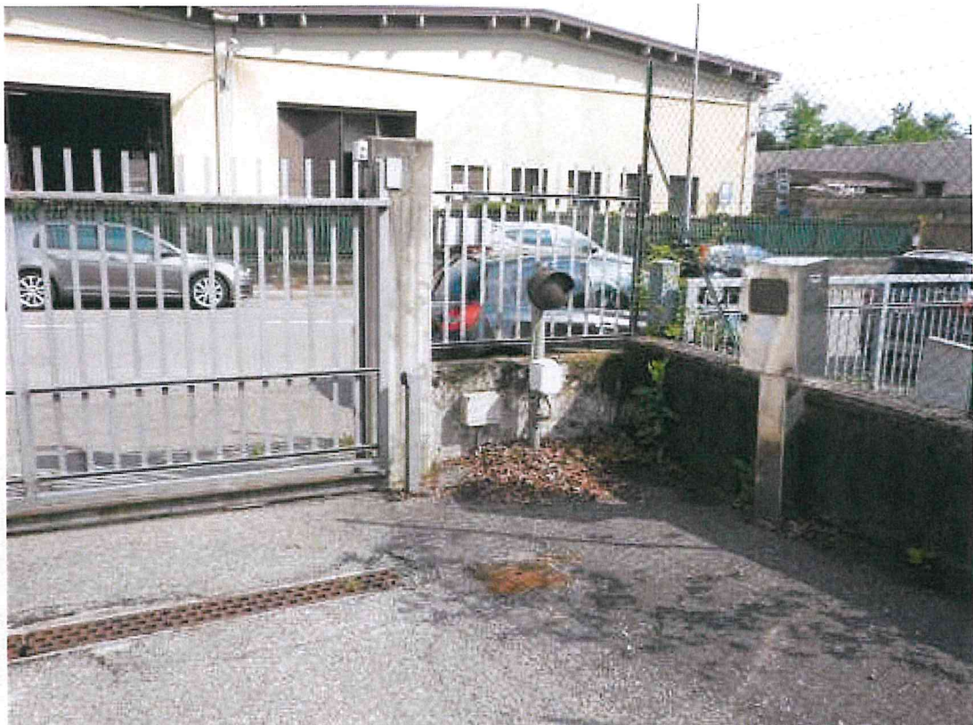
Foto 12 - Alcuni impianti agli ingressi su strada
