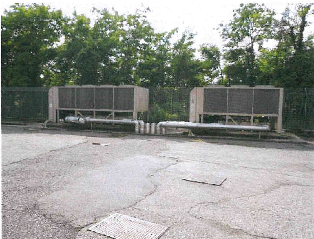
Foto 15 – Le unità esterne di condizionamento sul retro
