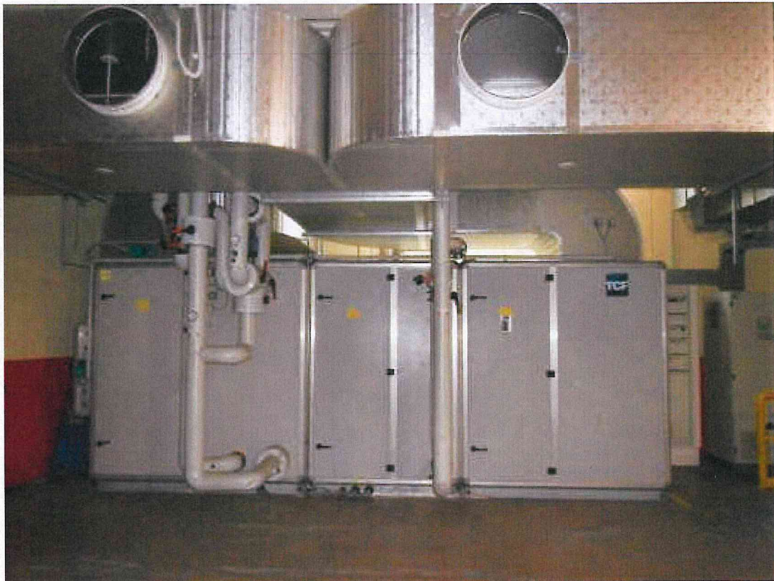
Foto 18 – Alcuni impianti più recenti
