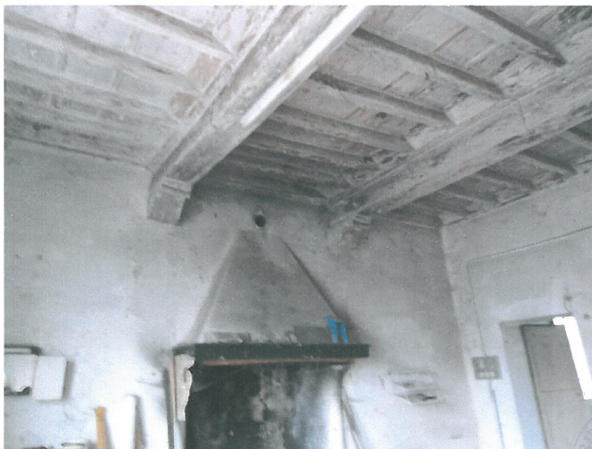
FOTO N. 23 SOFFITTI PIANO TERRA FABBRICATO 3 – VANO 1
