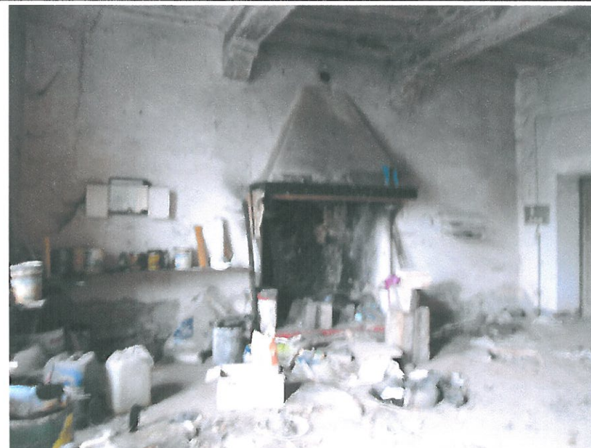
FOTO N. 22 INTERNI PIANO TERRA FABBRICATO 3 – VANO 1
