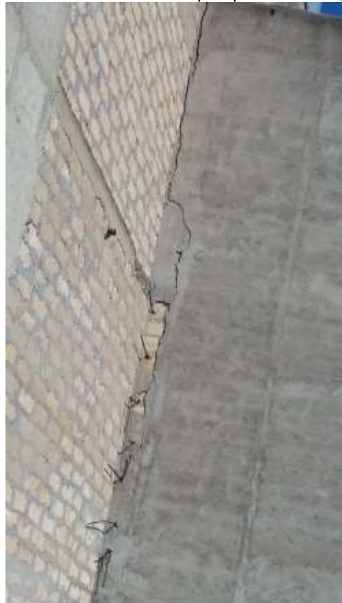
FOTO 4 - Particolare della lesione
