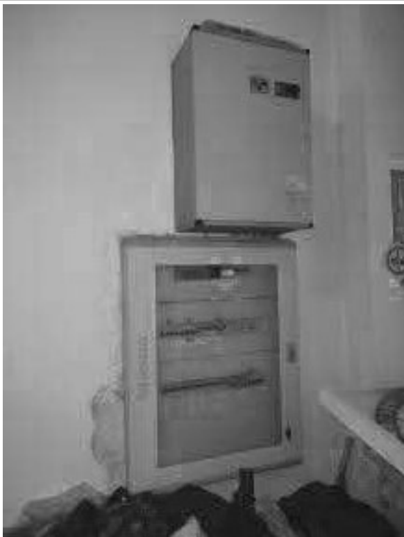
Quadri elettrici sub 3
