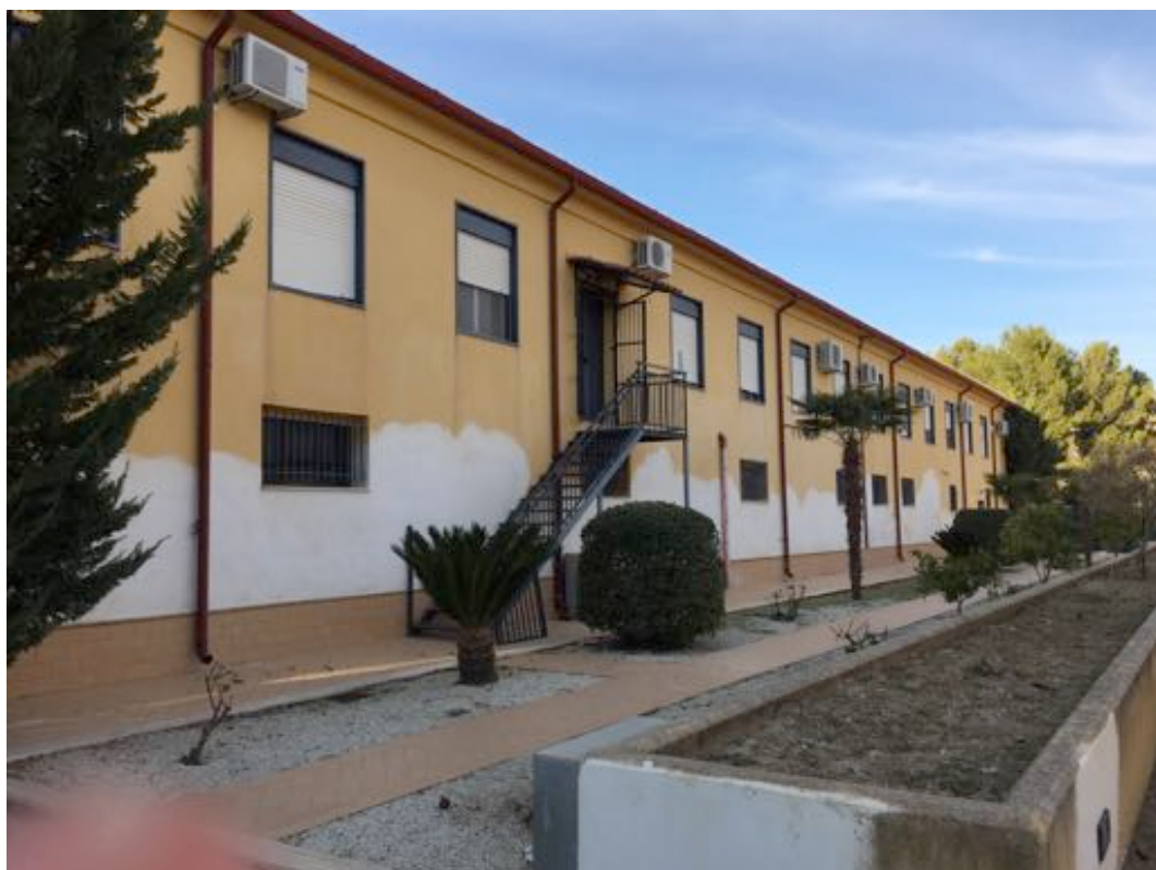
Foto 37 – Scala in ferro prefabbricata accesso al bene 3 -
