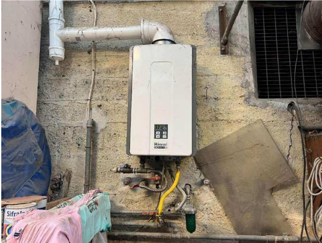
Figura 23 scaldabagno ubicato nella tettoia
