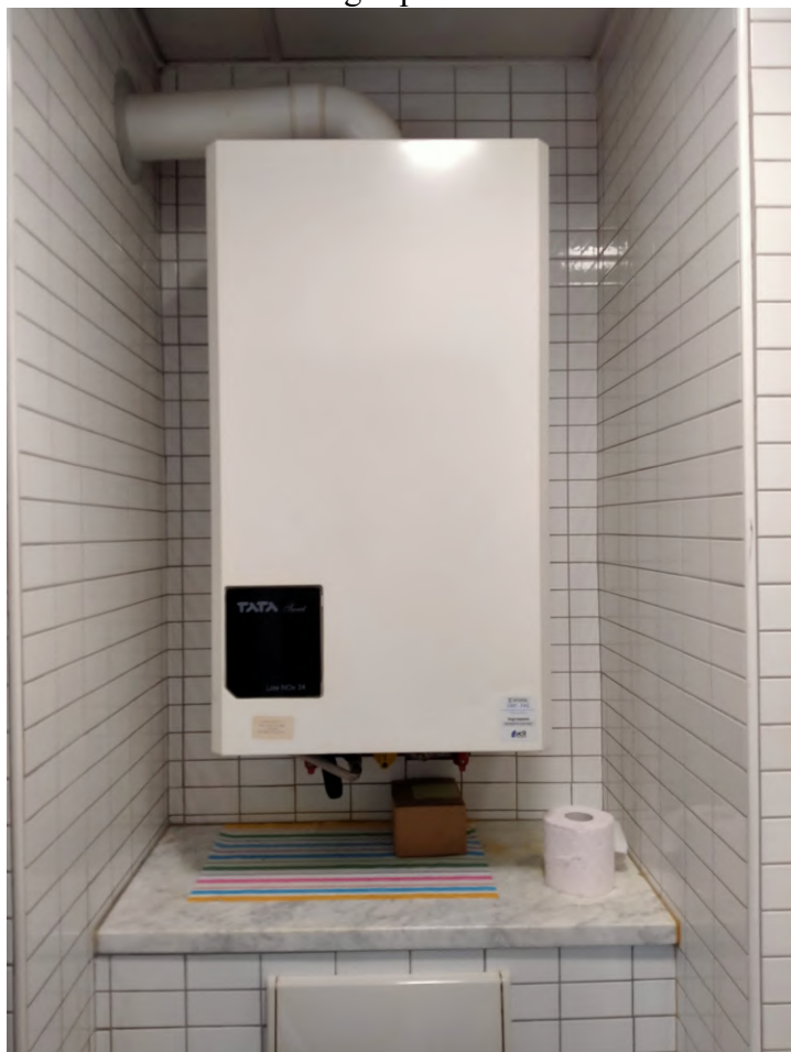
FOTO 17 – caldaia a gas presente nel secondo w.c.
