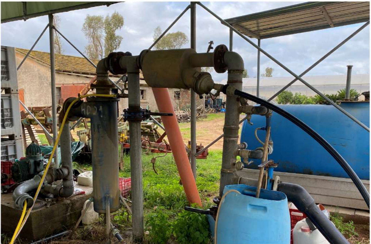
ESTERNO RAVVICINATO – DETTAGLIO POMPA E POZZO ARTESIANO
