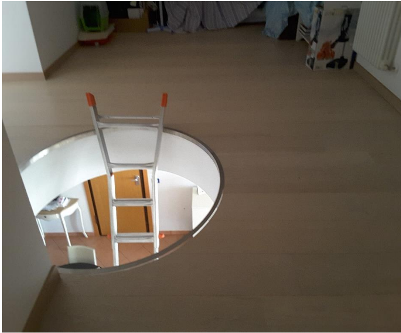
Vista foro presente sul pavimento del sottotetto
