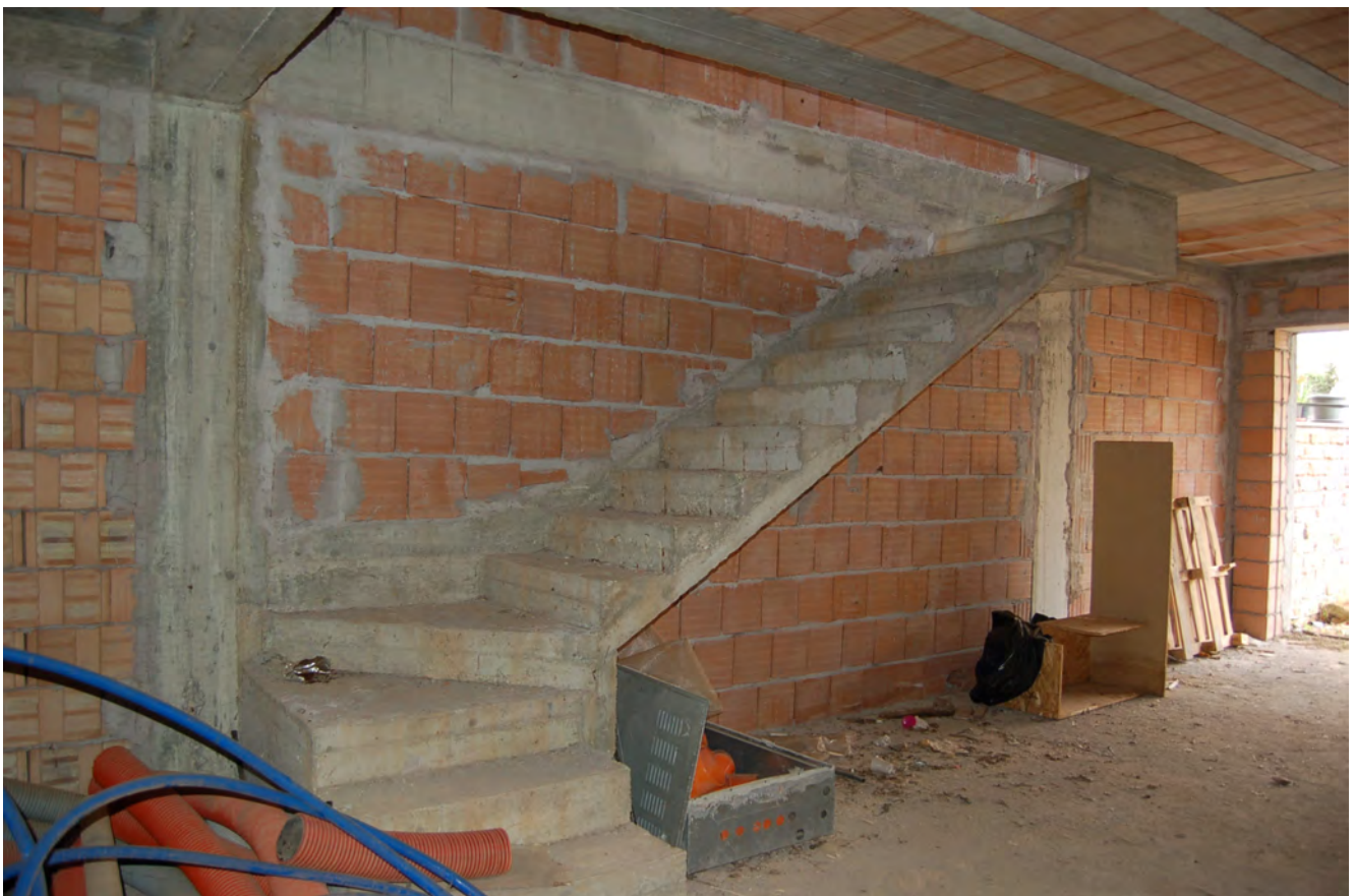
Foto 16 - Rampa di collegamento tra piano seminterrato e il piano terra (Villino distinto al N.C.E.U al fg.2 particella 1227, sub. 2)
