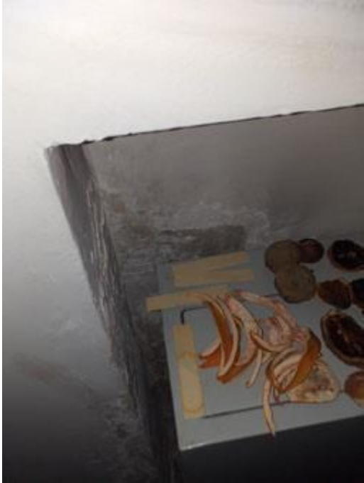
Presenza di umidità nella nicchia del vetilconvettore
