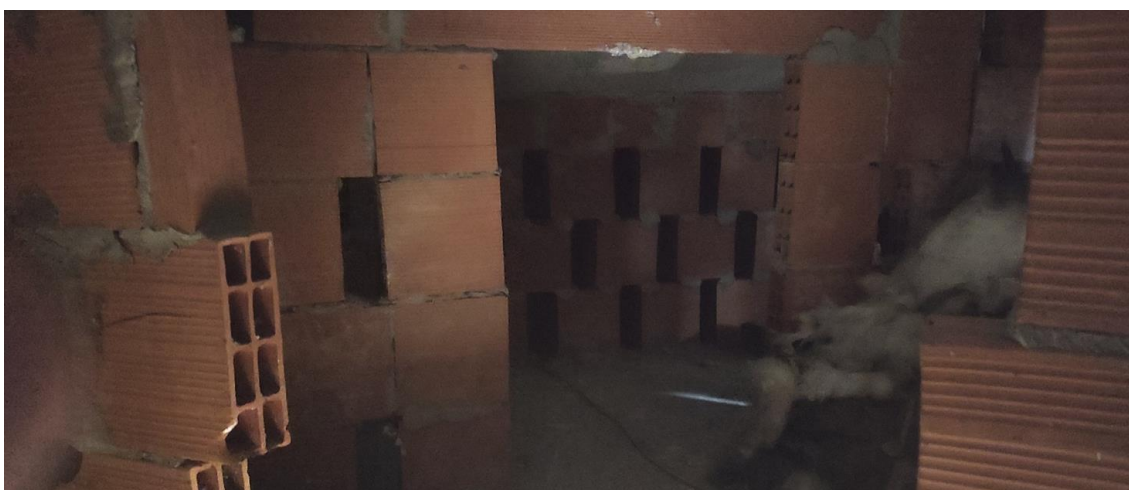
Figura 58: INTERNO 5B - vista di pareti poste nel sottotetto che si presume siano state realizzate pe sostenere il fotovoltaico senza verificarne l'incremento del peso gravante sulla struttura sottostante
