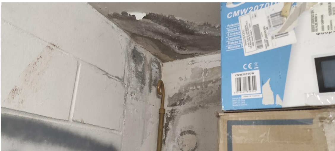
Figura 46: interno 7 - autorimessa 22 - con infiltrazioni d'acqua
