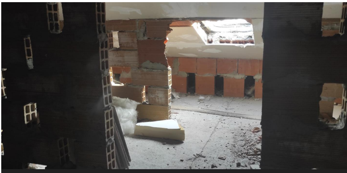
Figura 59: INTERNO 6B –vista interna del lucernario del sottotetto che non risulta essere idoneo per l’accesso in copertura per dimensioni e per assenza di spazio idoneo allo sbarco sul tetto
