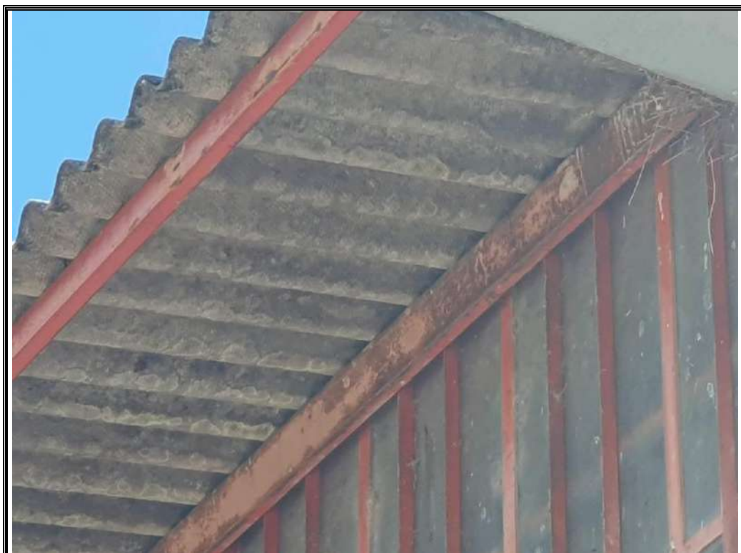
Foto n. 10 Copertura del fabbricato in ondulina di eternit.
