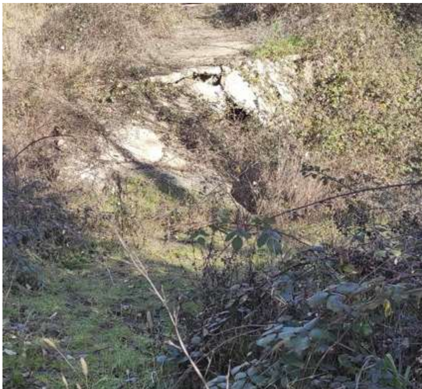
Figura26 : Esterno 16 strada crollata che consentiva l'accesso carraio alla cava
