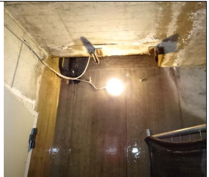
Palazzina G piano interrato vano reti tecnologiche
