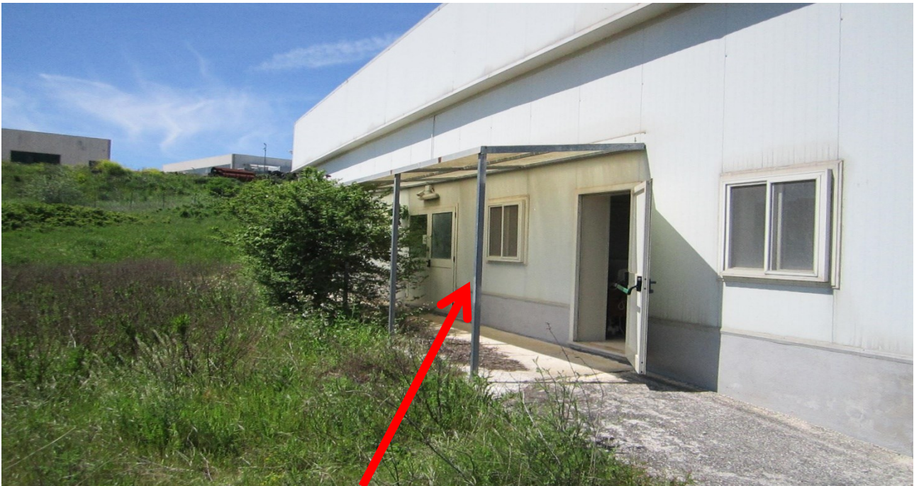
Tettoia realizzata in profilati in ferro e copertura in plexiglas in assenza di autorizzazione
