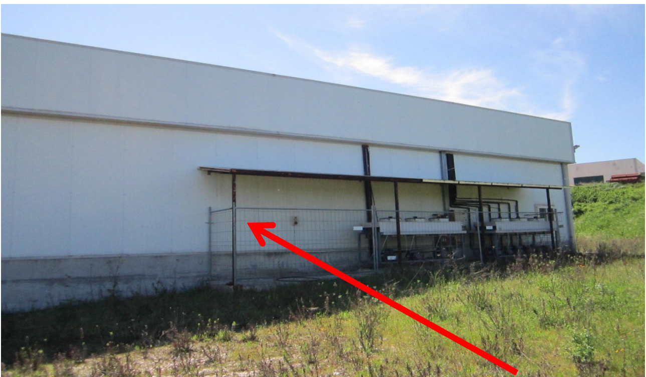
Tettoia realizzata in profilati in ferro e copertura in lamiera per ricovero Compressori in assenza di autorizzazione
