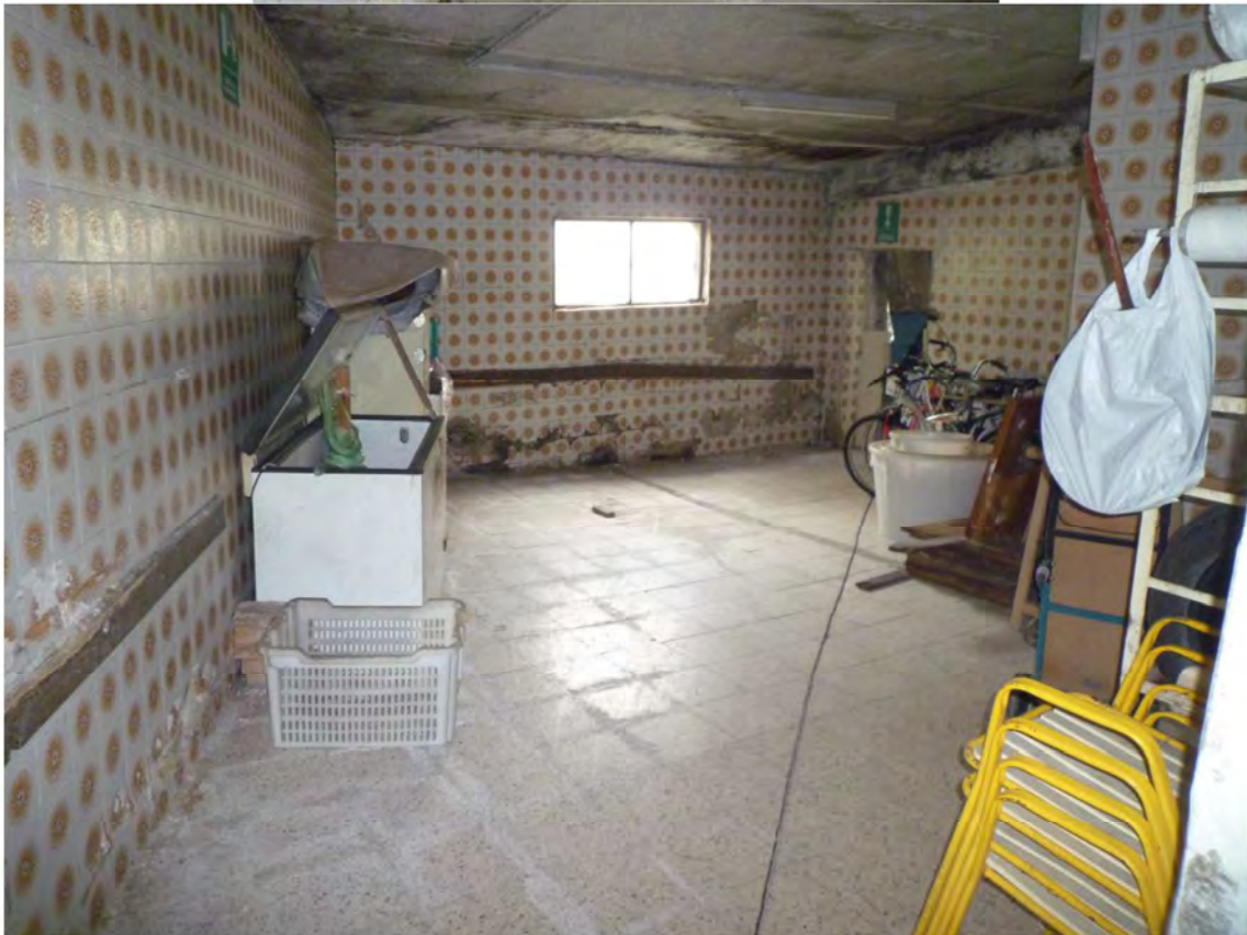
FOTO 32-33 deposito traccia di filo elettrico sul pavimento
