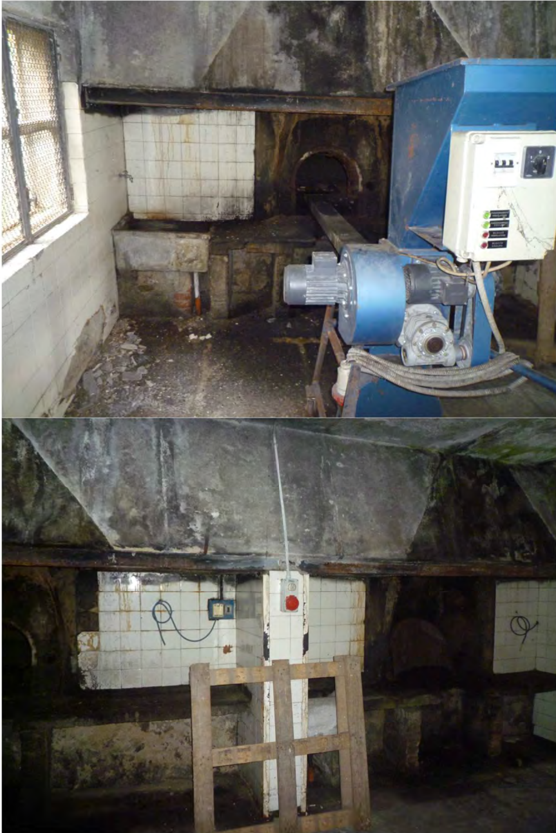
FOTO 38-39 forni a legna sala lavorazione 4
