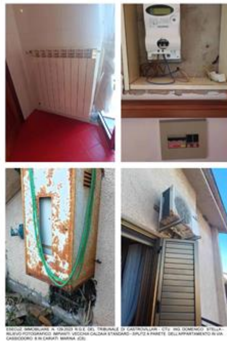
particolare impianti presenti
