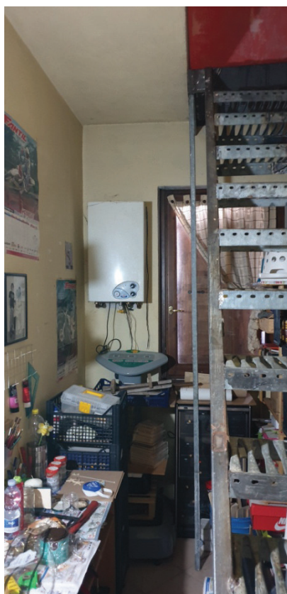
Foto n° 16: caldaia dell'impianto di riscaldamento non funzionante
