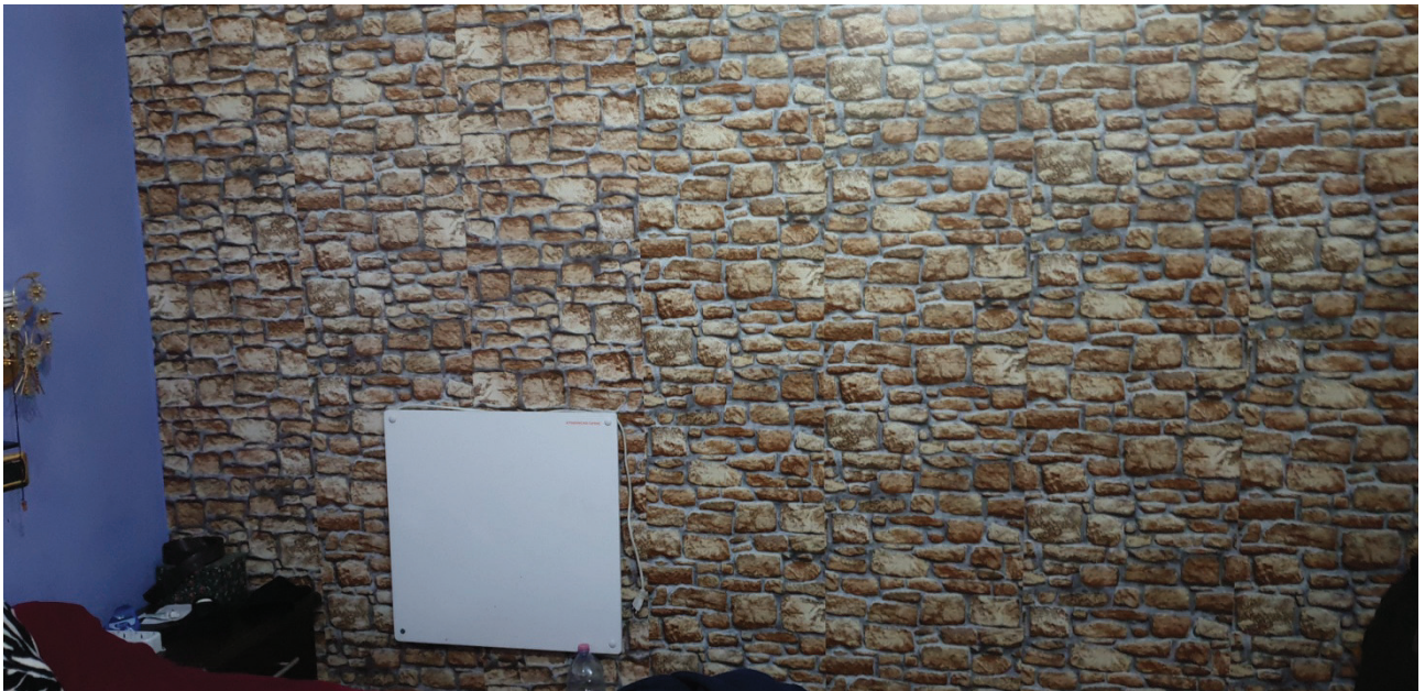
Foto n° 18: termoconvettore elettrico nella camera da letto
