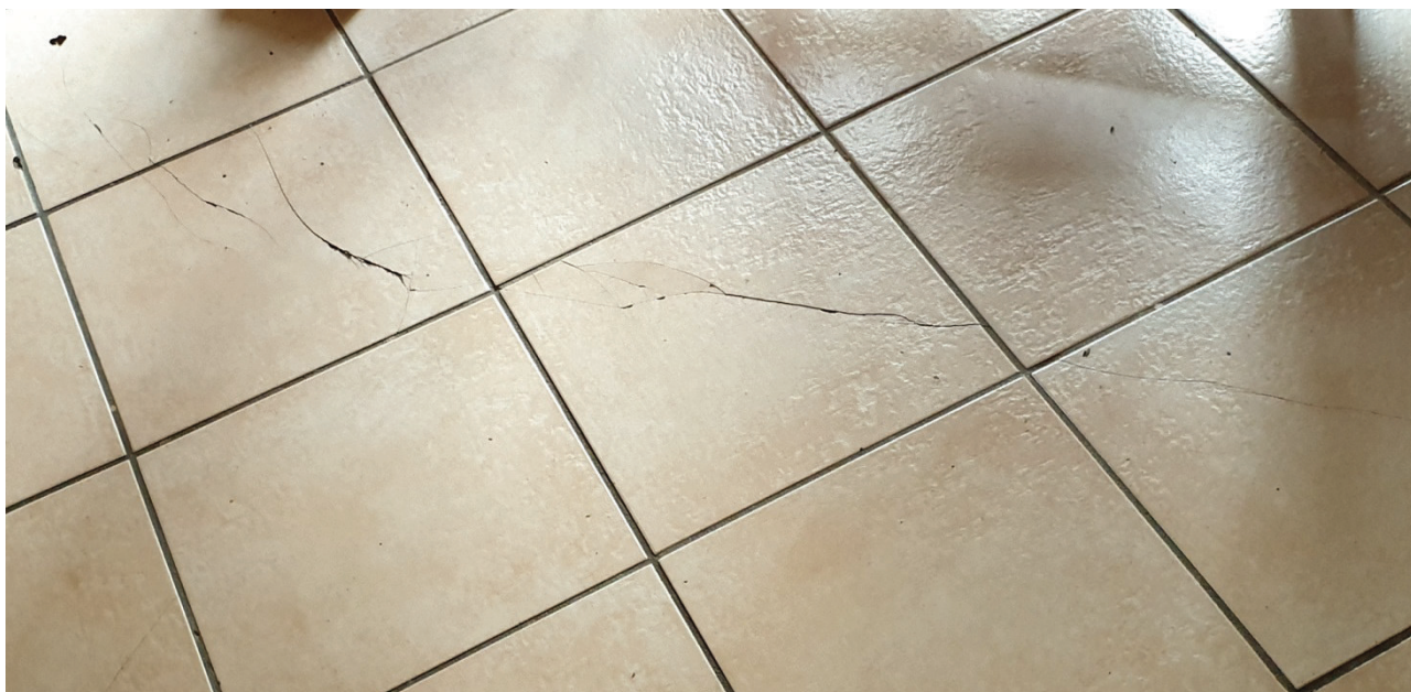
Foto n° 13: particolare del pavimento della cucina interessato dai recenti eventi sismici del 30/10/2016 e seguenti
