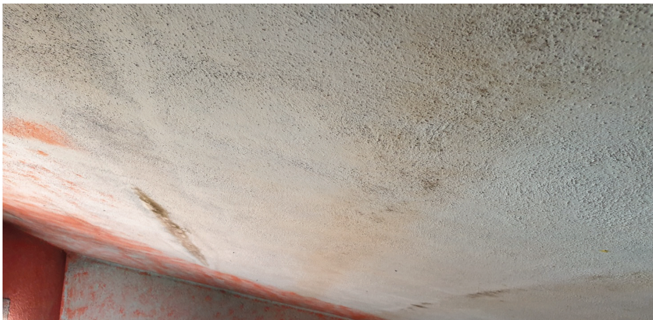
Foto n° 15: tracce di umidità sul solaio della soffitta
