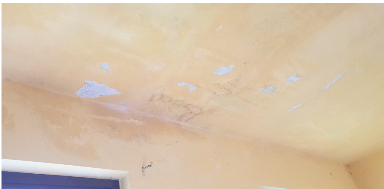
Foto n° 7/bis: macchie di umidità sul soffitto del vano scala
