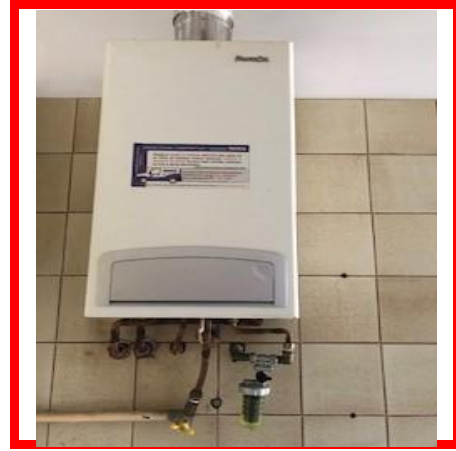
Foto 12- Caldaia all'interno della cucina.
