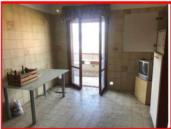
Foto 13 – Guano di piccioni sulla pavimentazione interna della cucina.
