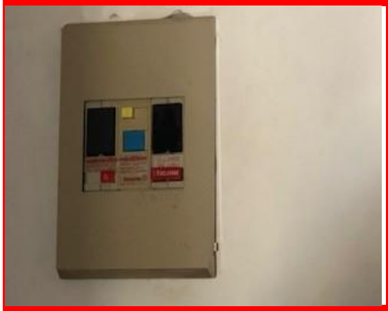
Foto 11 – Quadro elettrico a norma.
