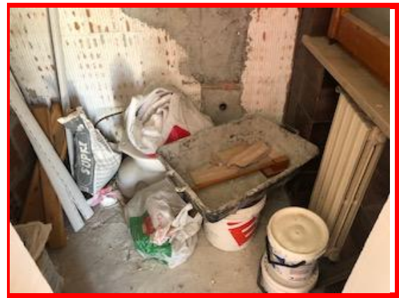
Foto 16 – Materiale e specifica attrezzatura edile abbandonata.
