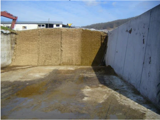
Foto silos orizzontali part.IIa n. 882
