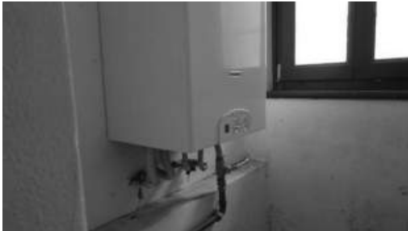
Vista ripostiglio con caldaia
