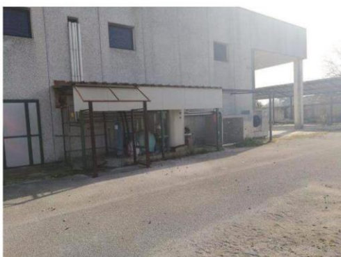
foto 45: ... impianto di climatizzazione
