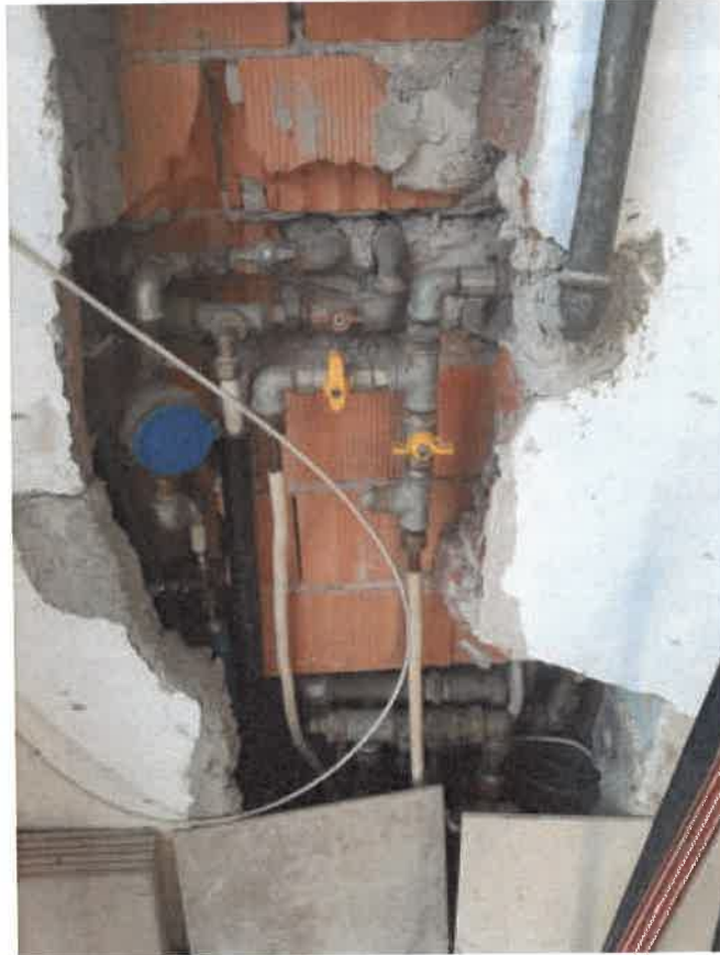
Generatore impianto riscaldamento e relativo impianto di adduzione / distribuzione
