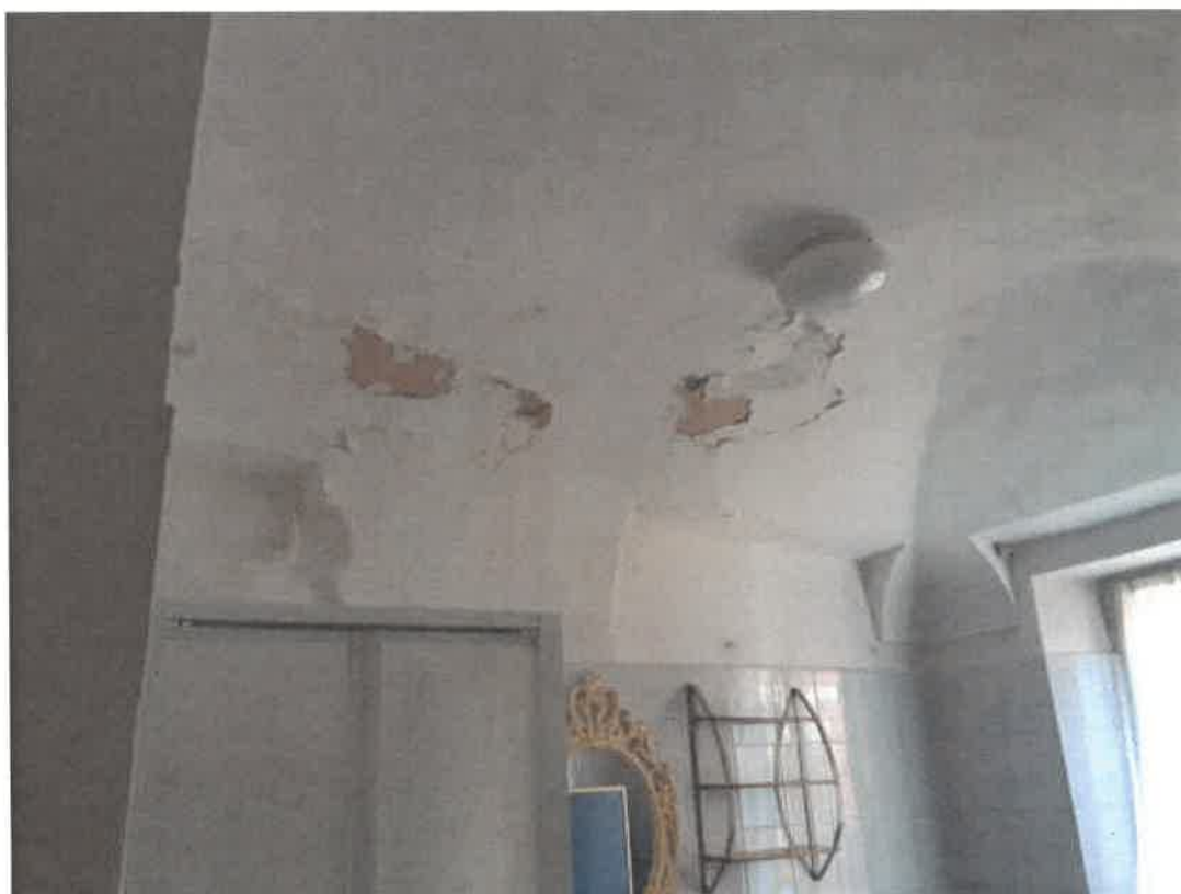
Ammaloramenti delle tinte sulle volte interne
