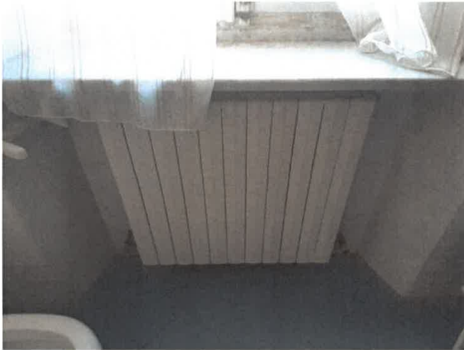
Tipologia batterie radianti impianto riscaldamento a servizio dei vani di abitazione
