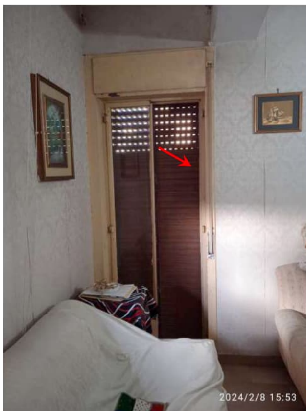
Foto n. 7 L'infisso esterno sprovvisto di anta interna.
