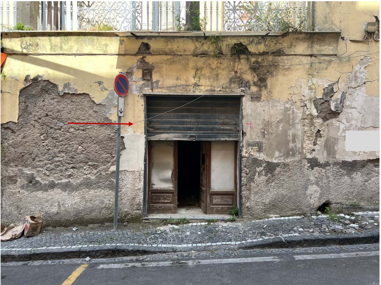
Foto 2 – Vista del dell'accesso al locale di via Carlo Alberto n. 82 – Boscotrecase (Na)
