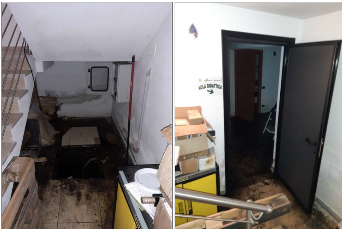
FOTO 28-29 – Vano scala al piano interrato: nel fotogramma a destra vista della porta che conduce a locali illegittimi sotto l'aspetto urbanistico-edilizio.
