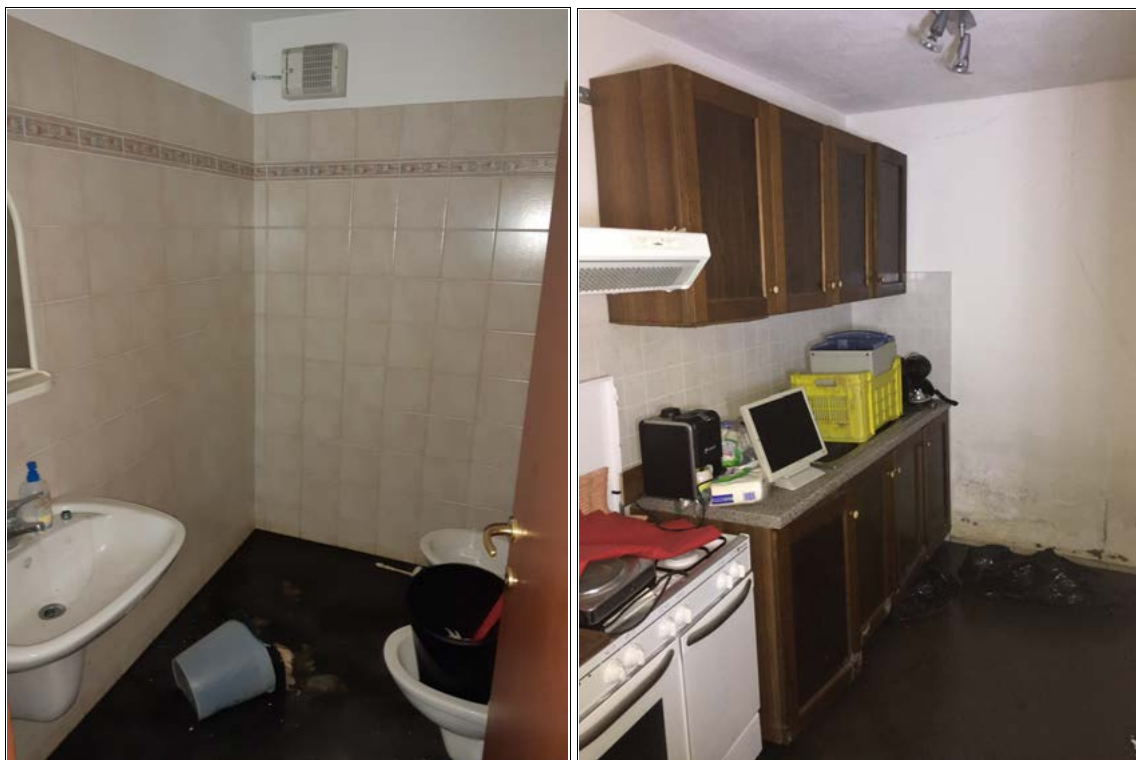
FOTO 34-25-36-37 – Locali abusivi al piano interrato.
