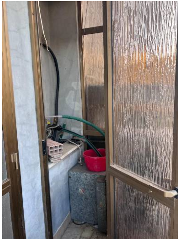
foto 11 - Particolare box caldaia
