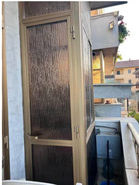
foto 10 – Box caldaia su balcone tinello/angolo cottura
