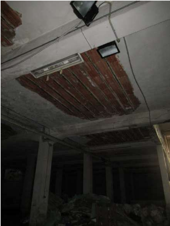
Foto 12_ Caduta intonaco su solaio
