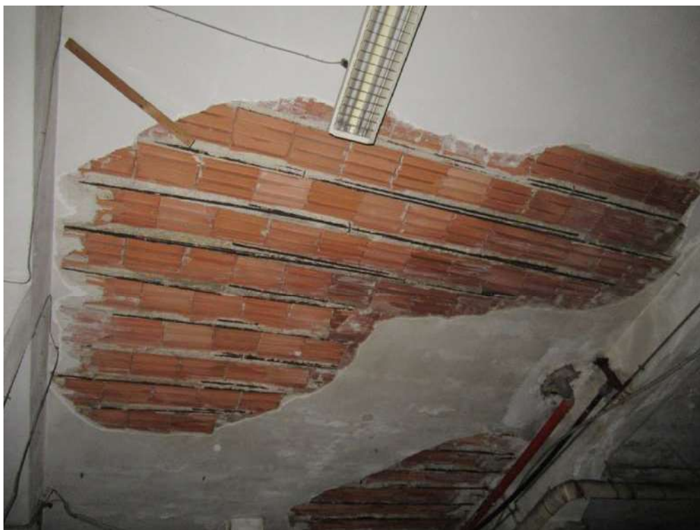
Foto 9_ Caduta intonaco su solaio
