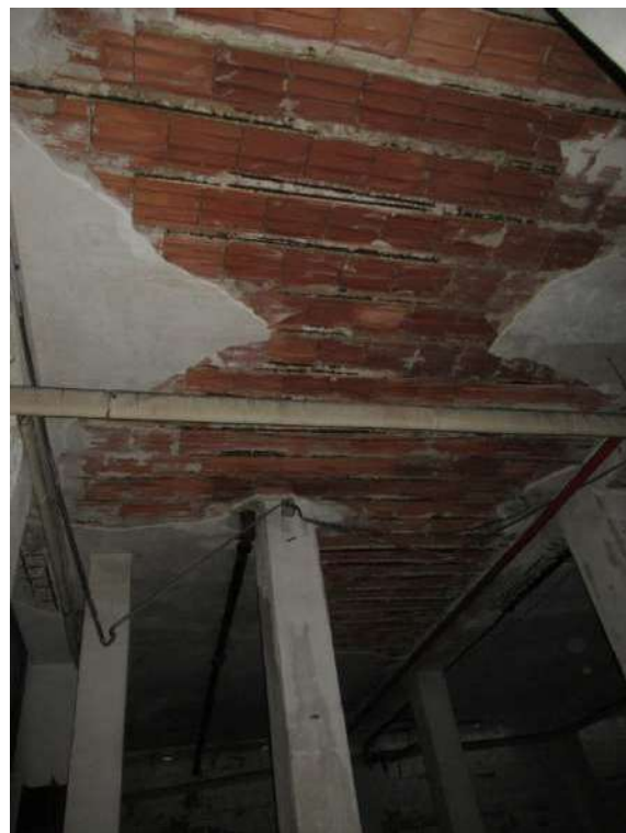
Foto 8_ Caduta intonaco su solaio
