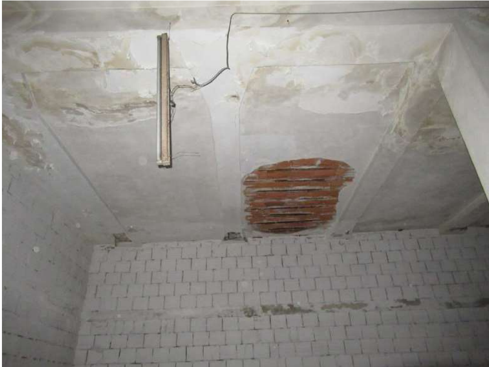
Foto 14_ Caduta intonaco su solaio e tracce di umidità
