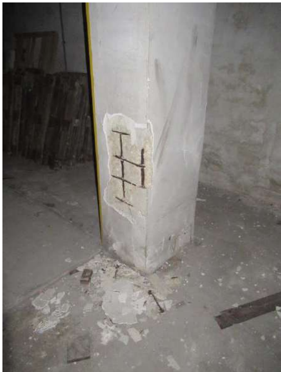
Foto 1_ Caduta intonaco copriferro
