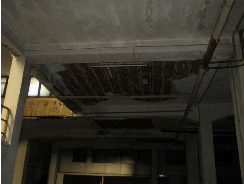
Foto 11_ Caduta intonaco su solaio
