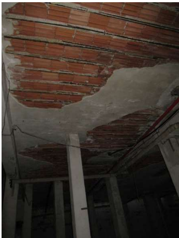
Foto 7_ Caduta intonaco su solaio
