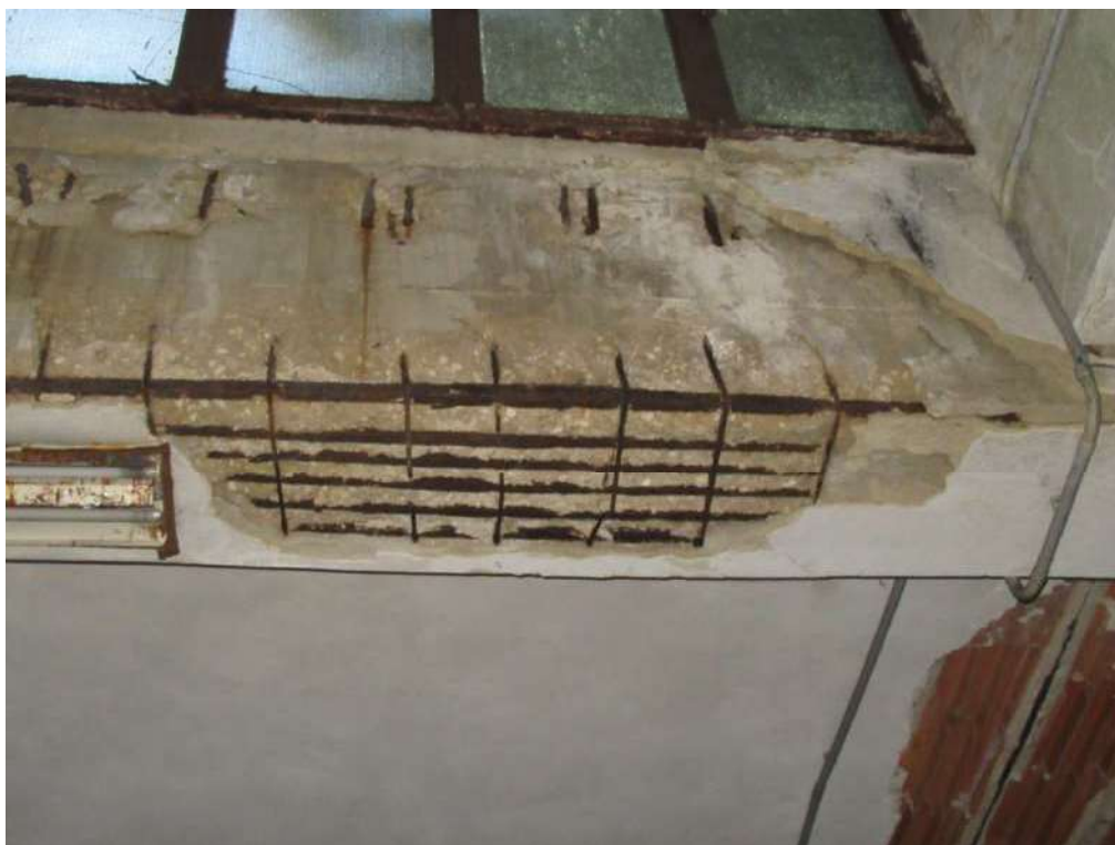
Foto 4_ Particolare caduta intonaco copriferro su trave
