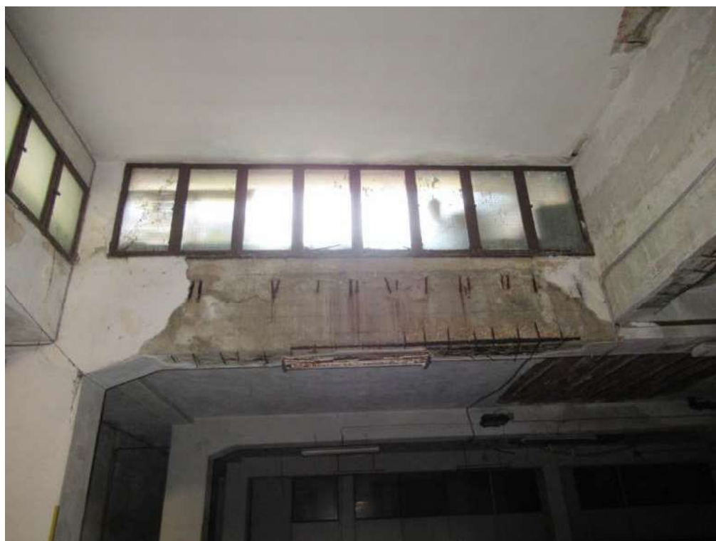
Foto 3_ Caduta intonaco copriferro su trave
