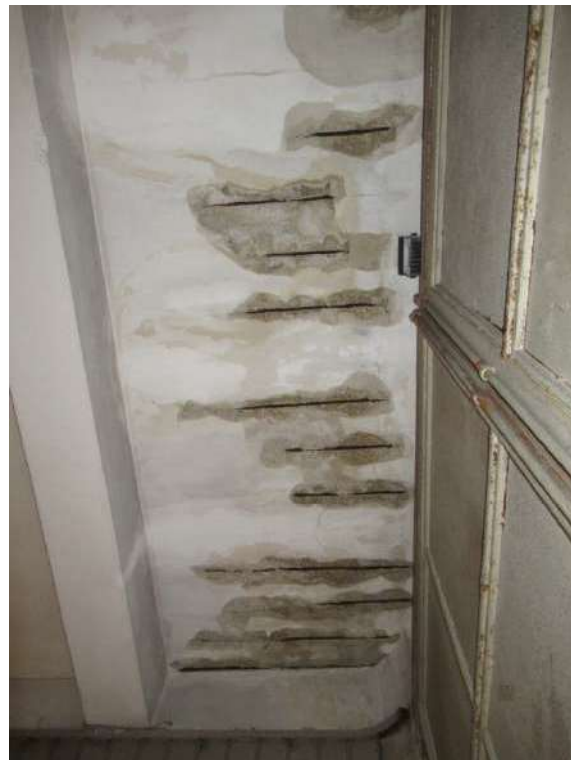
Foto 2_ Caduta intonaco copriferro su solaio
