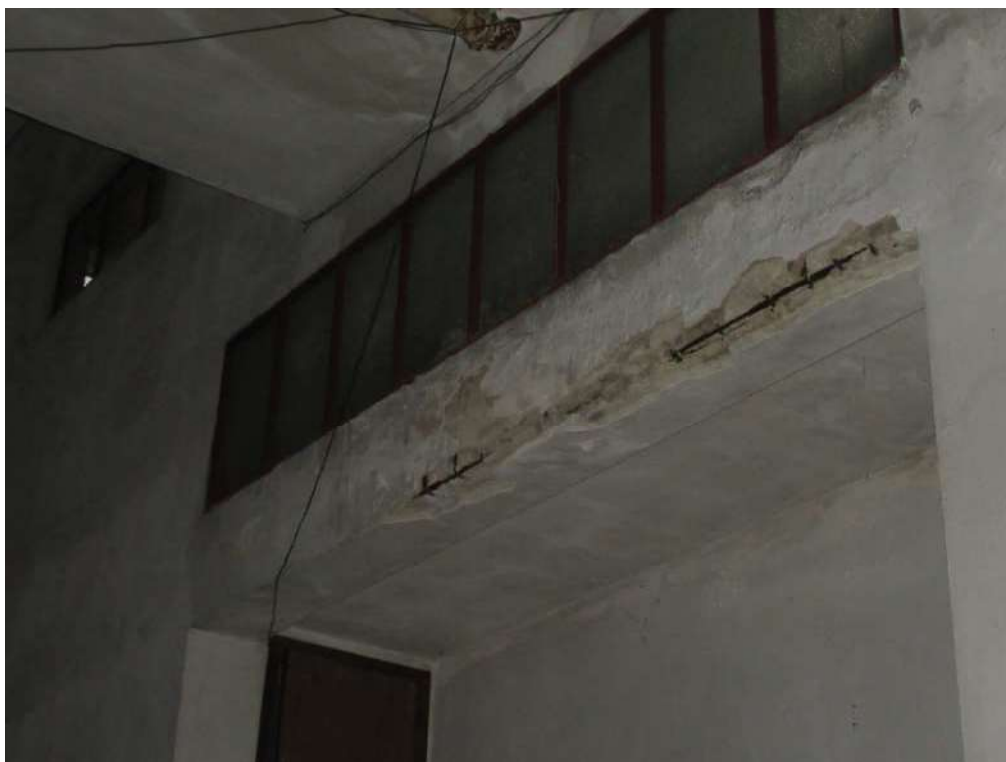
Foto 6_ Caduta intonaco copriferro su altra trave
