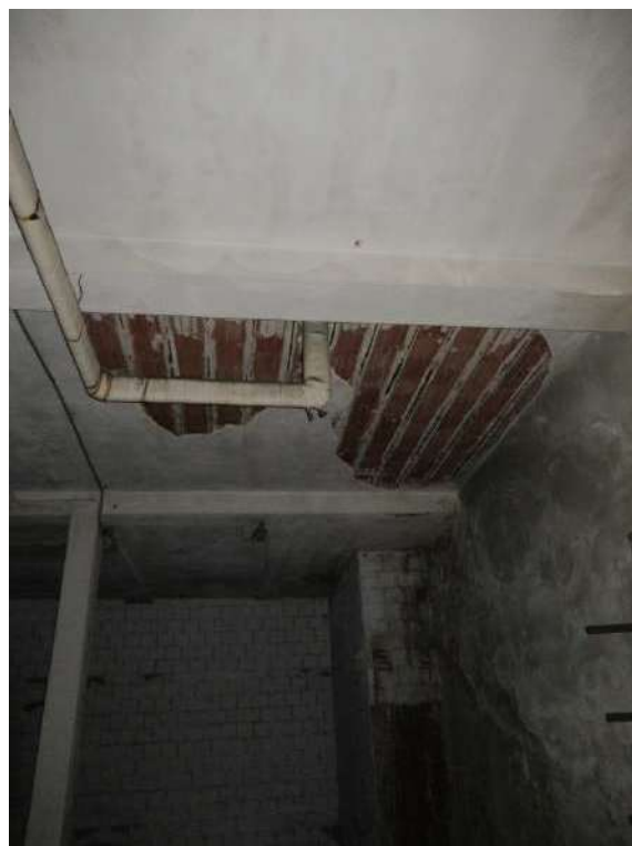
Foto 19_ Caduta intonaco su solaio e tracce di umidità alla parete
