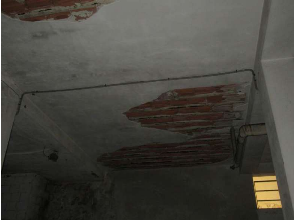
Foto 16_ Caduta intonaco su solaio e tracce di umidità
