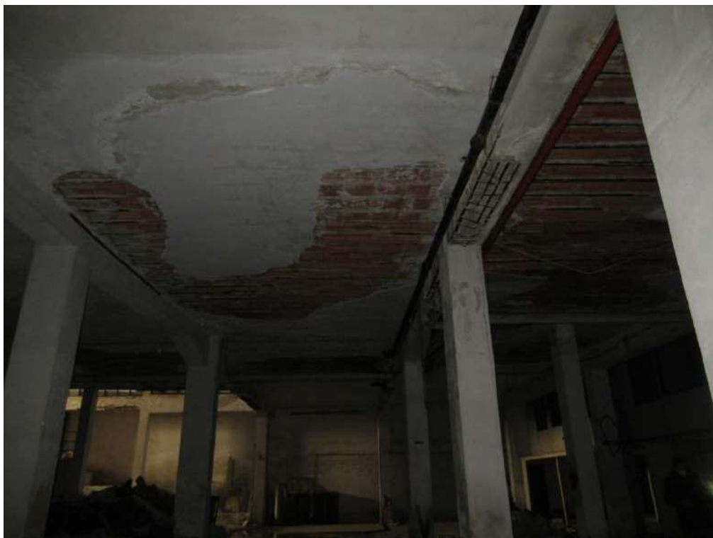
Foto 10_ Caduta intonaco su solaio
