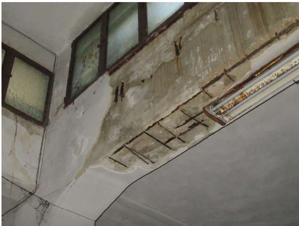
Foto 5_ Particolare caduta intonaco copriferro su trave
