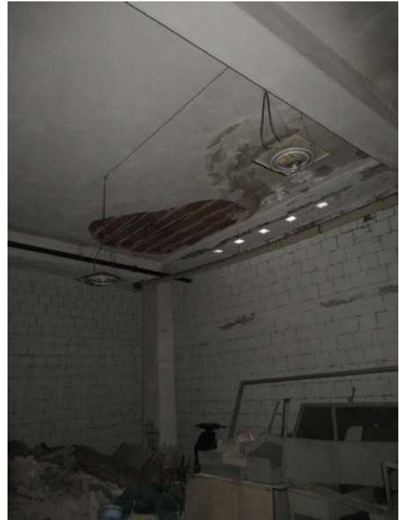
Foto 13_ Caduta intonaco su solaio
