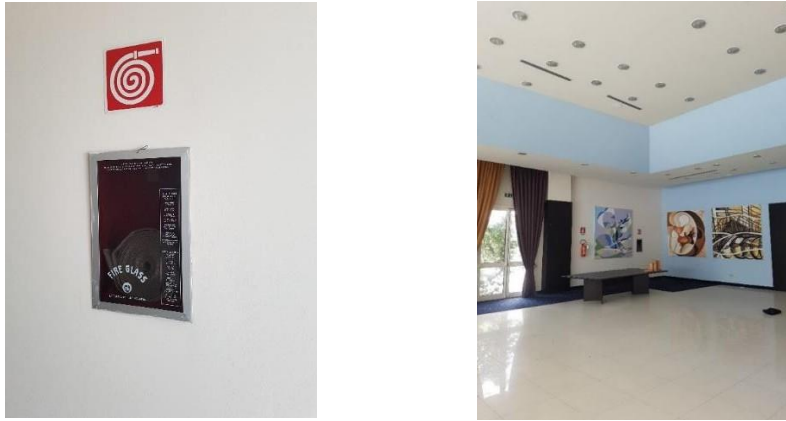
Figura 21 – Estintori e idranti dislocati nell'albergo
