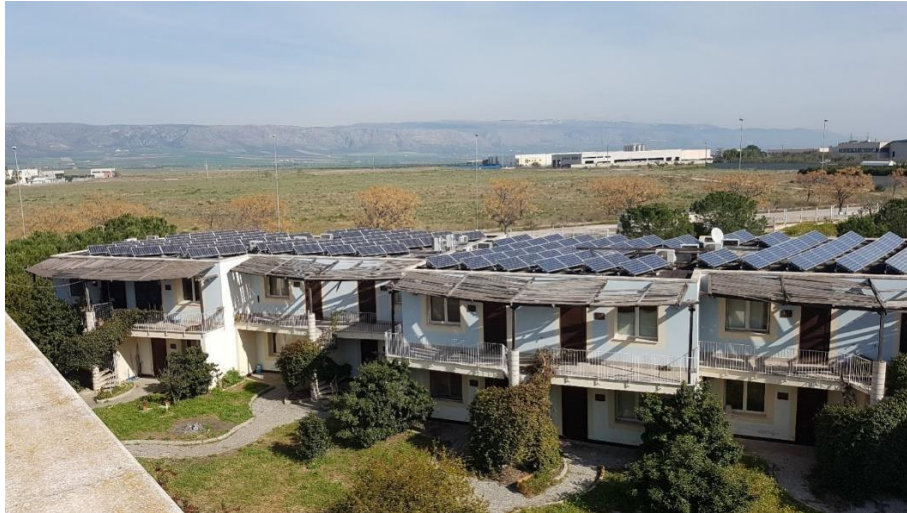
Figura 25 – Impianto fotovoltaico installato sulle coperture del blocco foresterie
