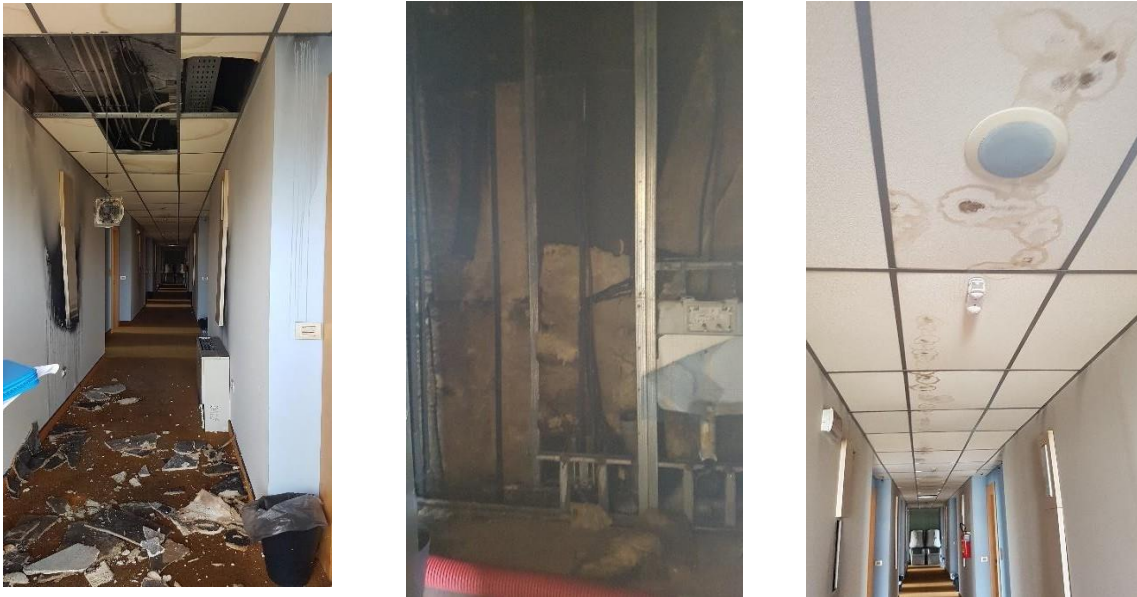
Figura 30 – Esempi di danneggiamento al secondo piano
