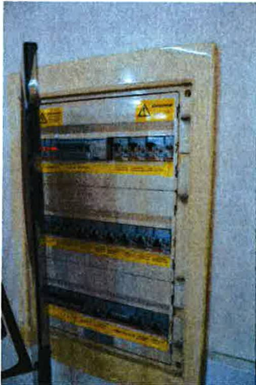
Fot. 19: piano primo, quadro generale impianto elettrico
