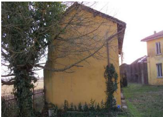
f.13 vista testa edificio A (crollo spigolo est)
