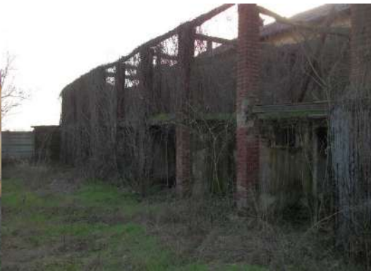
f.14 vista edificio B in stato di rudere
