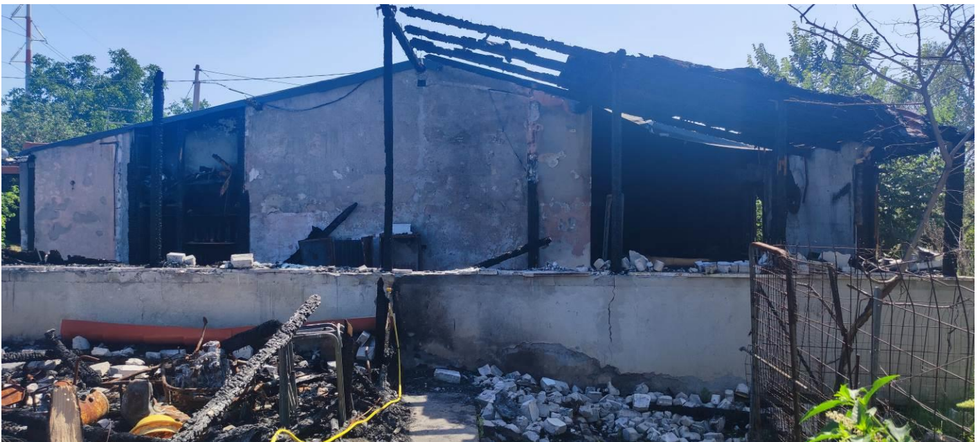
Zona dell'immobile oggetto di incendio ex edificio 4, stanza e corridoio (come da grafico allegato)
