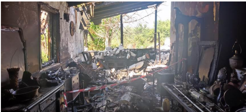
Corridoio con finestre ampliamento sub 4 distrutto da incendio
