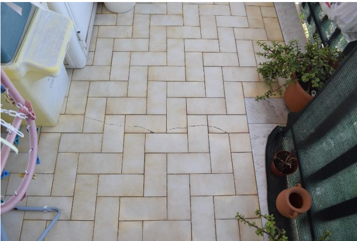
Foto 13) pavimentazione balcone ammalorata
