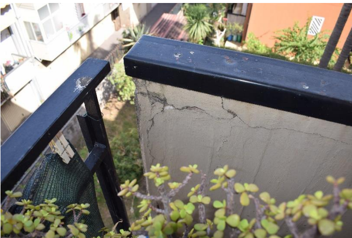
Foto 14) parapetti balconi ammalorati
