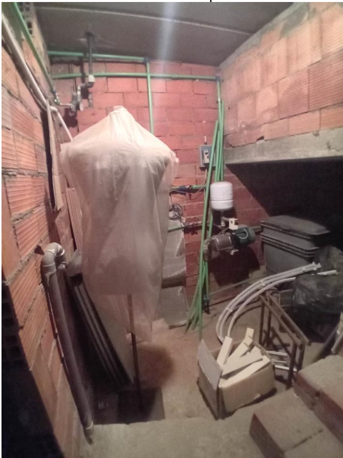
Vista del sub. 11 (impiantistica antincendio) NON OGGETTO DI PIGNORAMENTO
