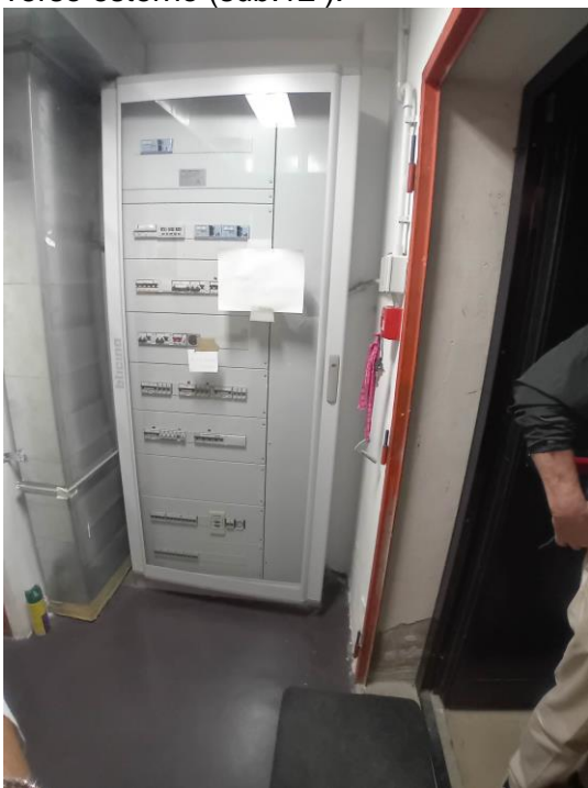
Quadri elettrici posti di fronte al servizio igienico
