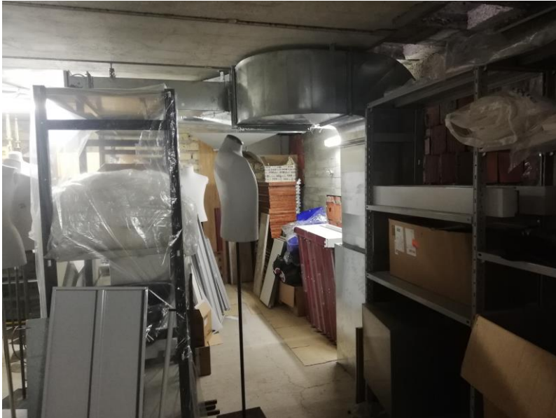
Locale Ripostiglio (3)- zona tecnica
