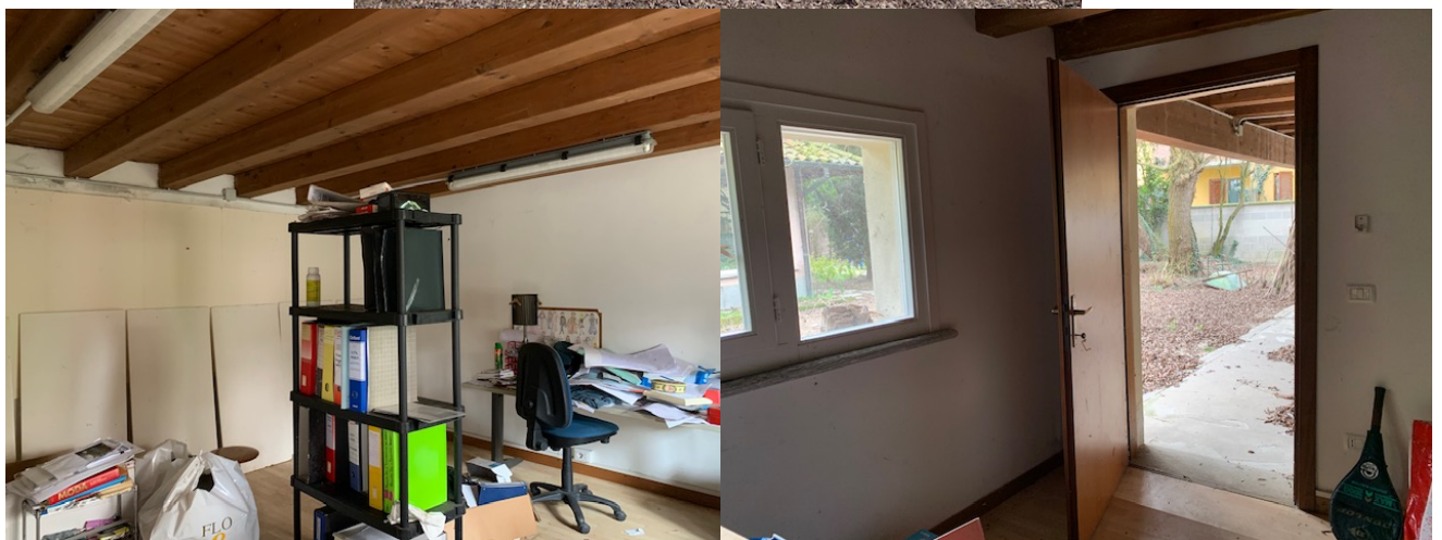
Tettoia in legno lamellare e locale deposito attiguo all'abitazione all'interno della corte comune (foglio 9 - mapp. 767)
