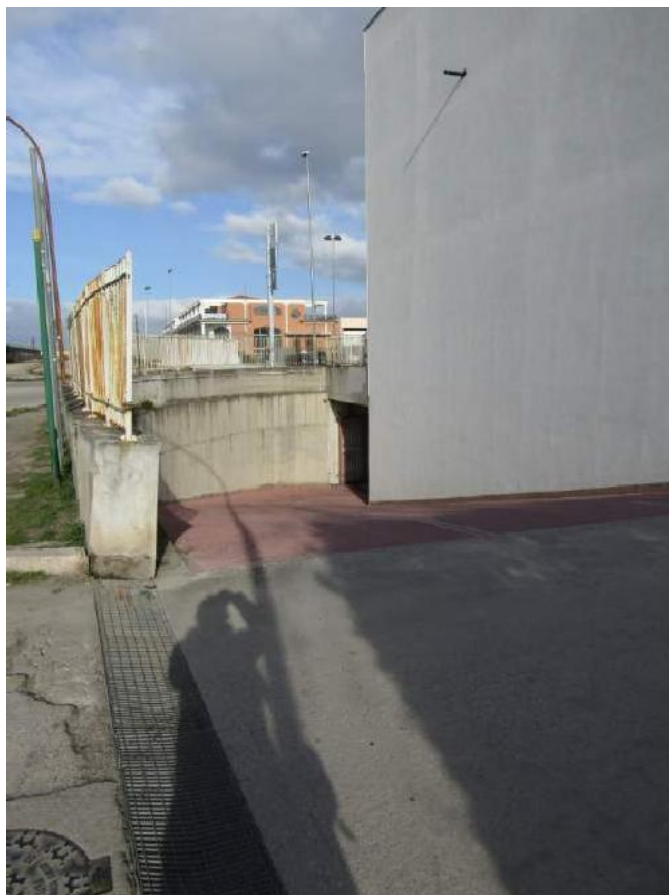
Foto 2.3 - LOTTO 2 - LABORATORIO ARTIGIANALE IN FOGGIA - FABBRICATO A - RAMPA DI ACCESSO AL PIANO S1
