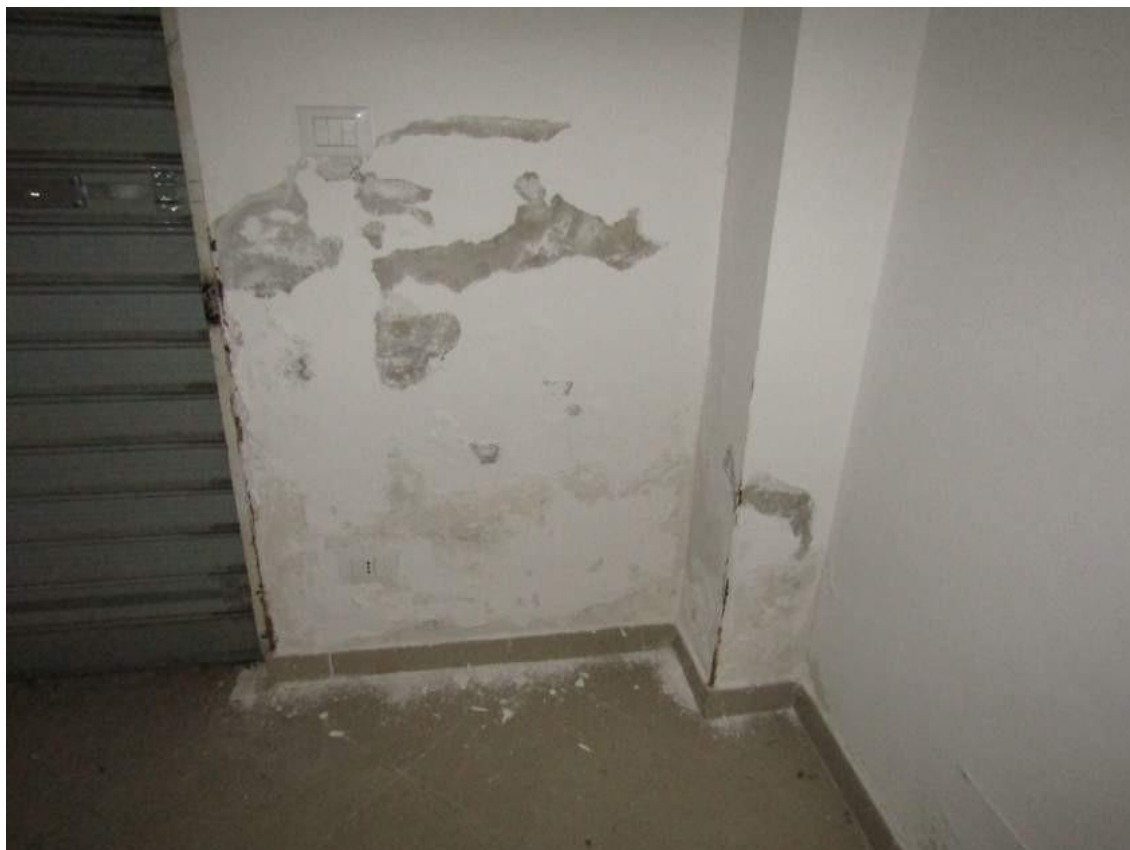
Foto 2.17 - LOTTO 2 - LABORATORIO ARTIGIANALE IN FOGGIA - PRIMO PIANO INTERRATO - UMIDITÀ DI RISALITA
