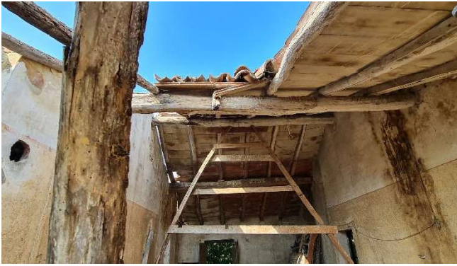
17. Stato conservazione copertura piano primo
