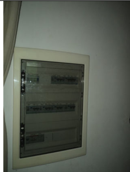
Particolare quadro elettrico
