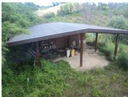
Foto identificative del Sub.6 poiché non sono presenti elaborati grafici nel Permesso di Costruire n.52/2008, pratica 78/2008 del 10/11/2008
