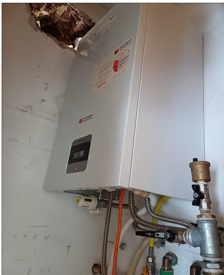
Foto 12 – caldaia posta al p.primo
