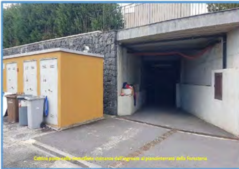
Cabina posta all'interno dell'area della cabina di M/T
