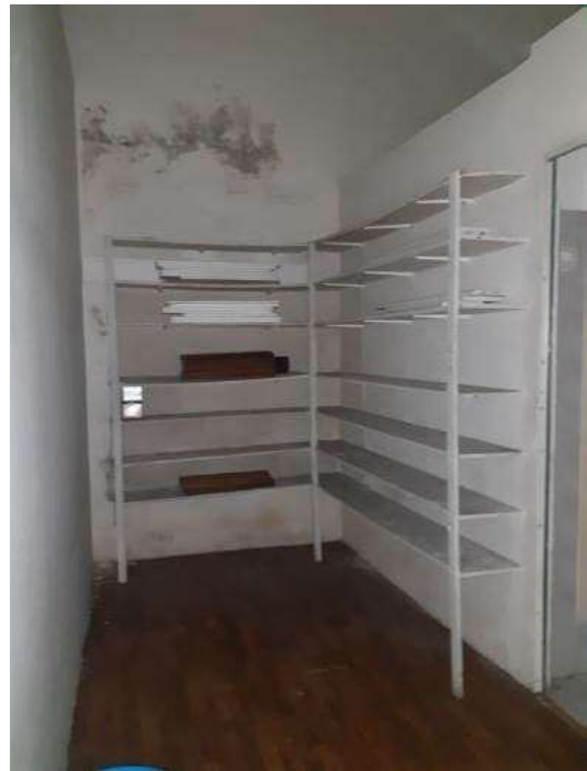
Foto 15 Zona servizio con wc
