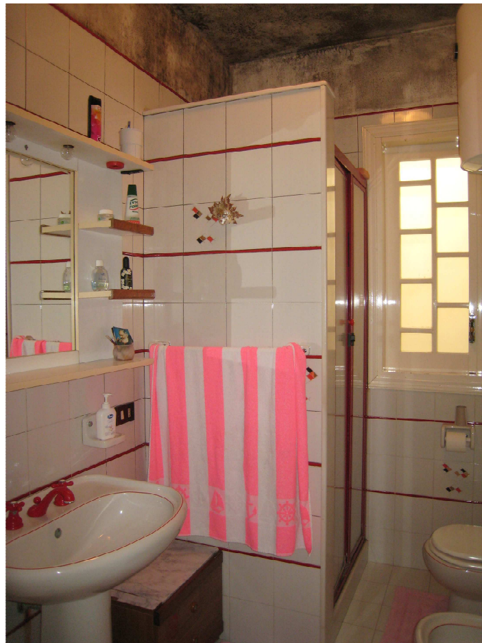
Foto n. 47. Il doppio servizio. Muffa alle pareti e tetto.
