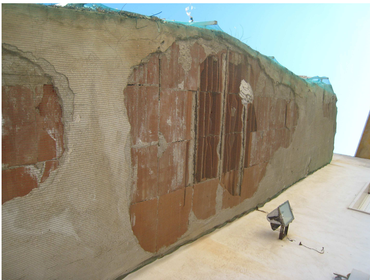
Foto n. 53. Il sotto balcone del piccolo alloggio di quarto piano è in pessime condizioni.
